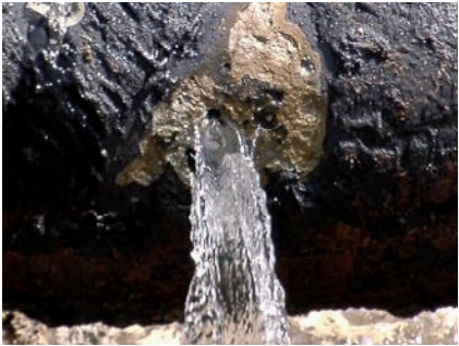
Fig. 1. Wypływ medium przez perforację korozyjną w rurociągu stalowym (ułożonym w gruncie)
