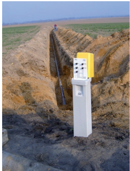
Fig. 4. Ochrona katodowa rurociągu - punkt pomiarowy (podczas budowy).
