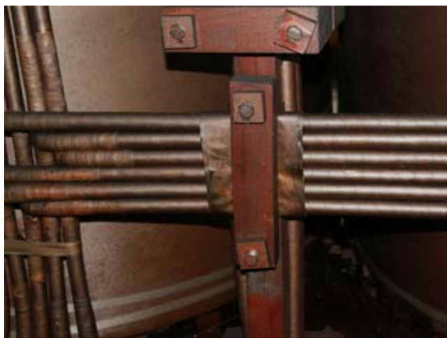
a. produkty starzenia oleju na odpyłkach uzwojenia regulacyjnego transformatora 25MVA o 32-letniej eksploatacji
