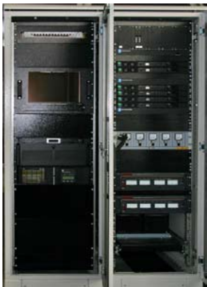
Ilustracja 2. Czołowa Stacja Bazowa DOTRA – widok od frontu
