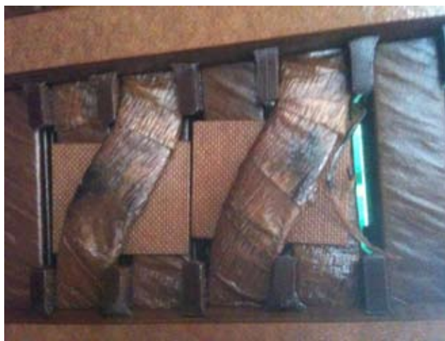
b. siarczki miedzi w miejscu przeplecenia przewodów równoległych uzwojenia DN transformatora 63MVA (faza B)
