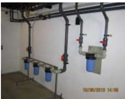
Zdjęcie 16: Integracja filtrów antymikrobowych AGXX w rurociągach zasilających wody demineralizowane
