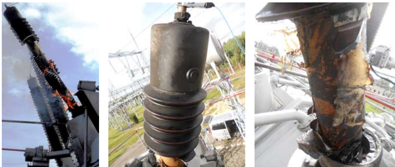
Fot. 8. Widok uszkodzonego izolatora przepustowego
